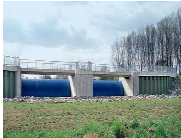
Figure 14 : Prise d'eau de sur l'île de Köller
